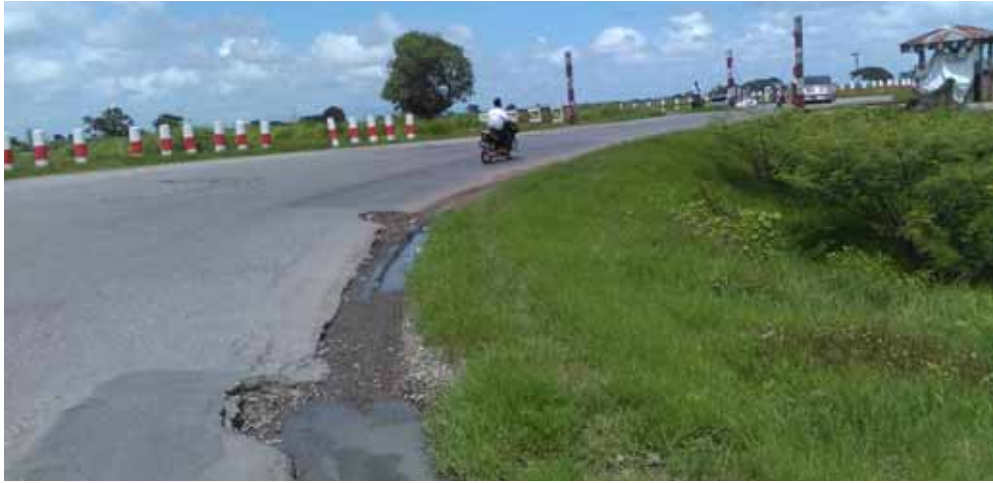
ဝေါမြို့နယ်အပိုင်း ကျိုက်လတ်ကျွန်းရှိ ရန်ကုန်-မော်လမြိုင် မီးရထားလမ်းနှင့် ကားလမ်းဆုံနေရာဖြစ်ပြီး ယင်းလမ်းဆုံ ယာဉ်ကြီး ယာဉ်ငယ်များ ကွေ့ထွက်မောင်းနှင်ရာတွင် အလွန်ကျဉ်းမြောင်းနေသည့်အပြင် ကတ္တရာလမ်းများပုံကျနေခြင်းဖြစ်ပေါ်လျက်ရှိ၍ သတိထား မောင်းနှင်နေရကြောင်း ယင်းလမ်းအသုံးပြုသူ ယာဉ်မောင်းတစ်ဦးက ပြောပြသည်။ သတင်းနှင့် ဓာတ်ပုံ - အောင်ကြီး(ပဲခူး)
